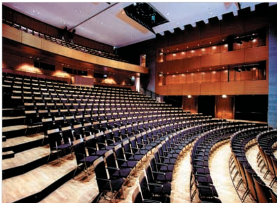
Werkbild: SBS Bühnentechnik GmbH Mehrspindelhubanlage zur Saalpodienverstellung im Kulturzentrum Frankfurt/Oder.
